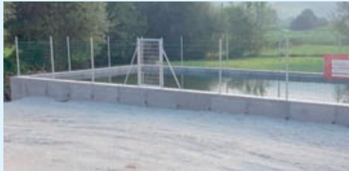
O novo depósito de auga
