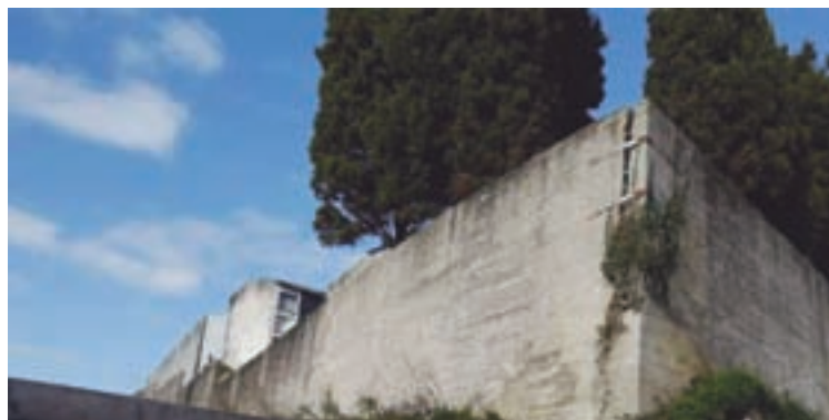
Estado no que se atopaba o muro do cemiterio
